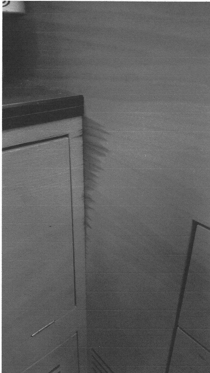
Infiltrations d'eau dans le coin cuisine
