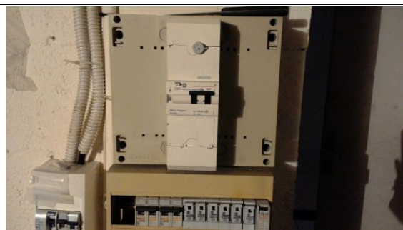
Disjoncteur de branchement
