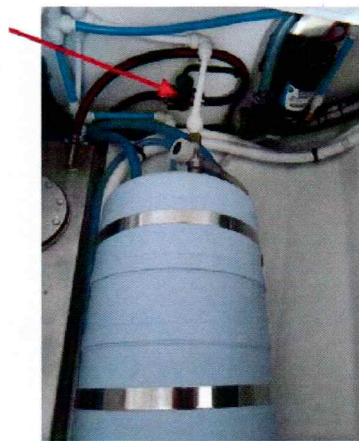
Vanne d'alimentation carburant Implantation : Compartiment technique (Coffre de cockpit tribord)
