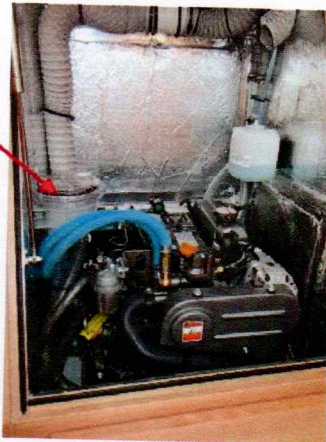
Filtre eau de mer Implantation : Compartiment moteur
