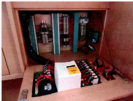
Implantation : Derrière tableau électrique
